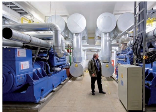
Abwärme flexibel nutzen: Kraft-Wärme-Kopplung mit Wärmespeicherung
